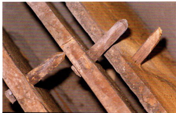
Abb. 4 u. 5 Fehlböden im 1. Stock, wie sie bei Renovie- rungen zu Tage kamen
